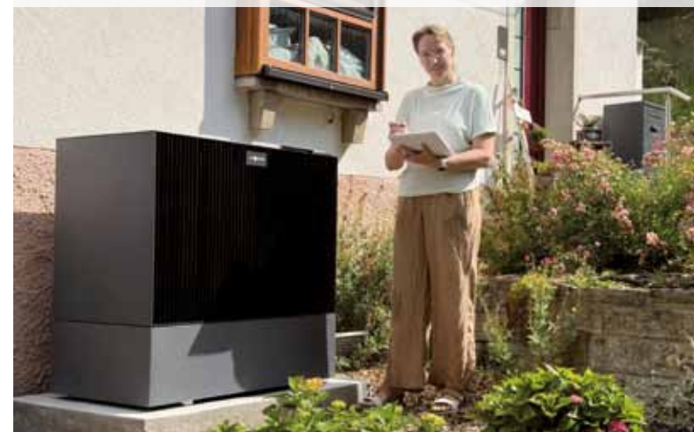
... und an der Wärmepumpe
